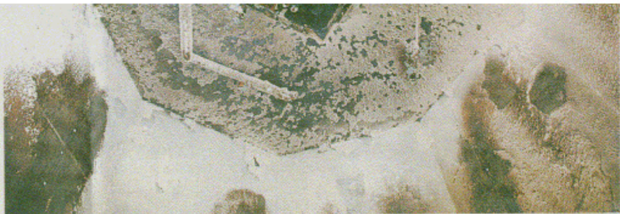
Die Filteranlage ist vollständig ausgebrannt.
